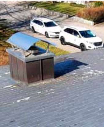
Die Schindeln rund um das Kamin sind brüchig.
